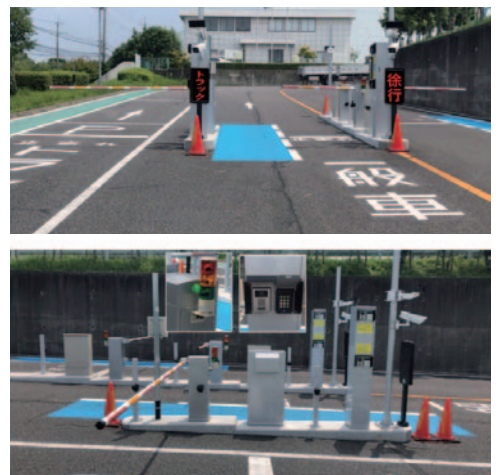
【パーキングゲートアイ事例】 大和リース株式会社 滋賀水口デポ/関西工場
