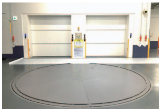
東京都内の自動車ディーラーへの導入事例。ターンテーブルと組み合わせることでスペースの有効活用が可能に。車の出庫時の注意喚起として、2基の中間パネルにパトライトを設置している
