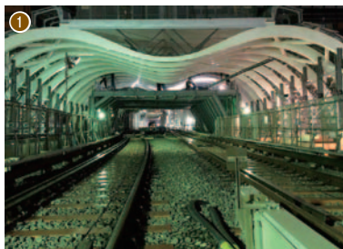
① 銀座線渋谷駅は移設され、2020年1月に新ホーム供用開始予定 ② 日比谷線の新駅・虎ノ門ヒルズ駅は東京2020大会前に供用開始
